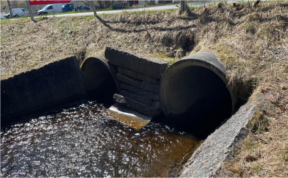
Figur 6-9. Vetevägen, dubbeltrumma betong (1200 mm).
