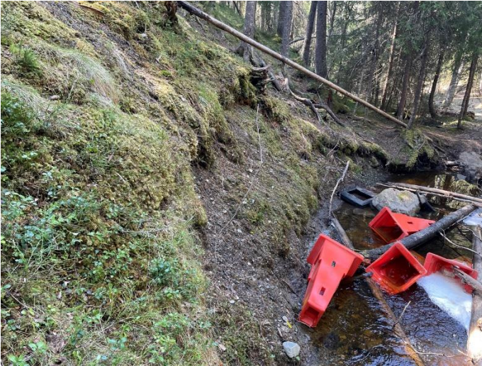
Figur 4-4. Tecken på erosion i södra ravinslätens fot.
