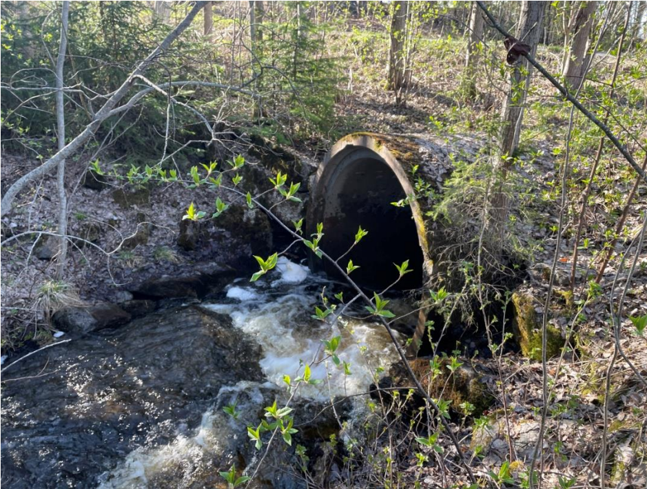
Figur 6-5. Lokal väg, trumma betong (1800 mm).
