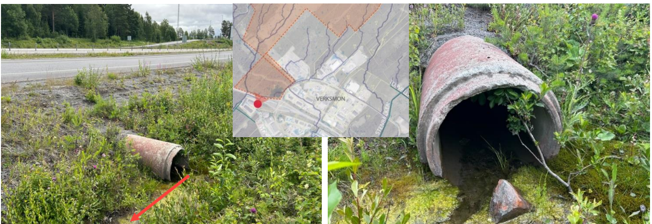
Figur 22. Visar trumma under E14 från vägdikey norr om vägen i angränsning till utredningsområdet. Trumman är i betong med dimension på 600mm och var vid tiden för fältbesöket fylld upp till 0,1 m med dagvatten.
