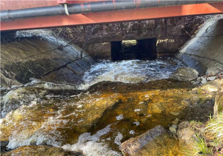
Figur 6-7. Opevägen, stentrumma under bilväg. (bredd = 1,4 m och höjd = 1,2 m) samt gångbro uppströms.
