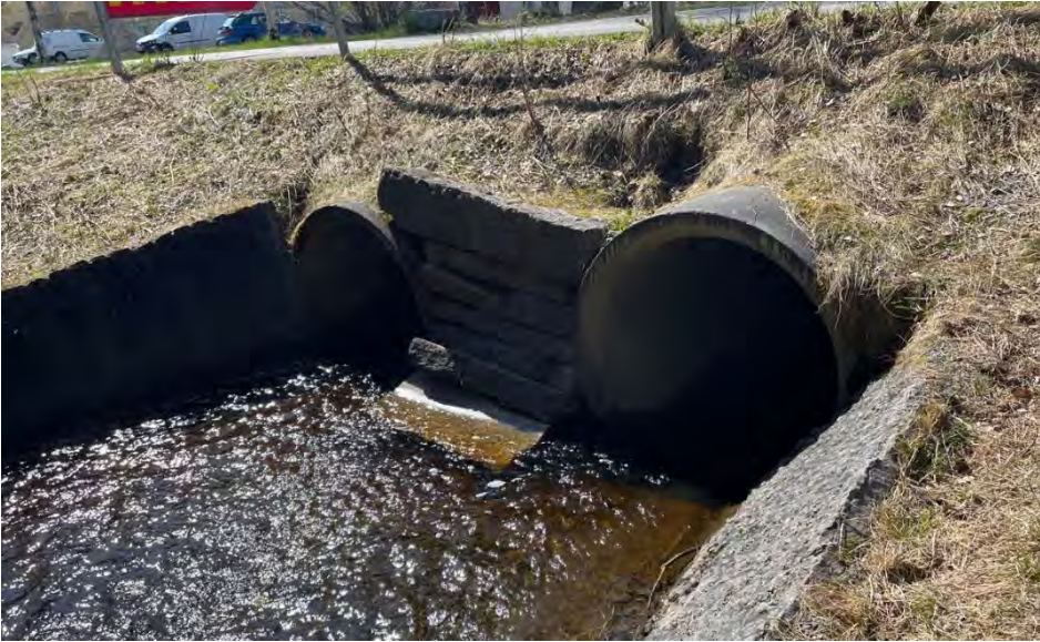
Figur 6-9. Vetevägen, dubbeltrumma betong (1200 mm).
