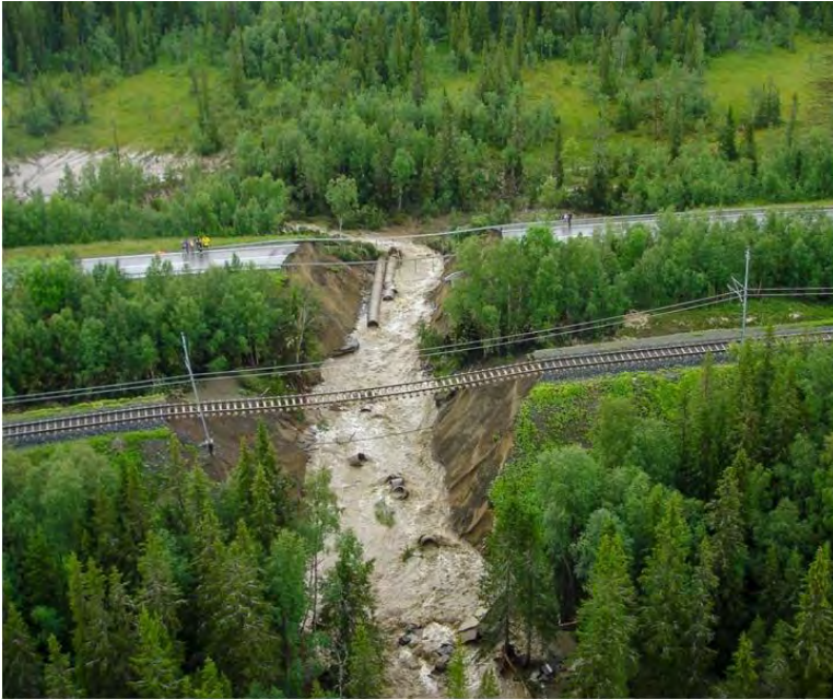
Figur 6-1 Kollapsad väg- respektive järnvägsbank i Ånn år 2006. Foto Morgan Göransson Lind.
