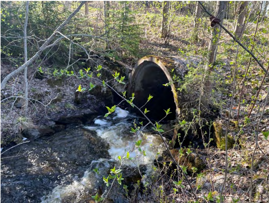
Figur 6-5. Lokal väg, trumma betong (1800 mm).
