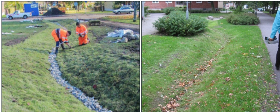
Figur 21. Till vänster, svackdike med synlig kross. till höger, svackdike med grön toppyta.
