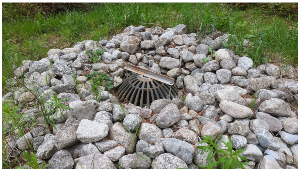
Bild 4.2 Bräddningsbrunn i närheten av Svanvägen
