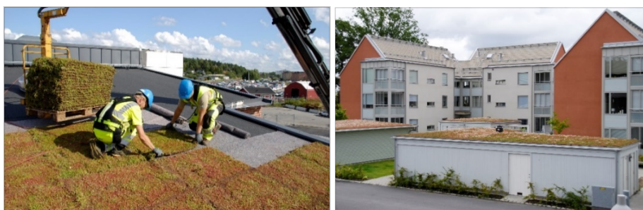
Figur 14. Anläggning av gröna tak till vänster och färdigt tak på miljörum till höger, bilder från vegtech.se.
