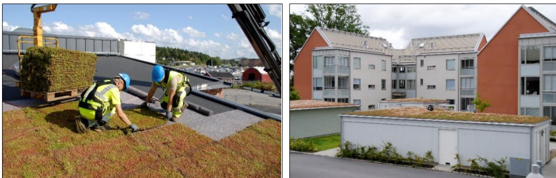
Figur 17: Anläggning av gröna tak till vänster och färdigt tak på miljörum till höger, bilder från vegtech.se .
