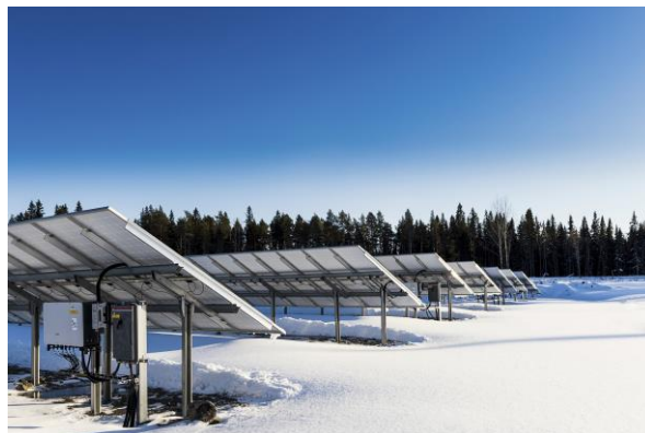
Med solcellsparken tog Östersundshem ett stort steg mot att bli självförsörjande på förnybar el.
